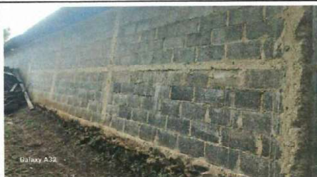
Foto 2: Vista exterior de las aulas donde se requiere repello, actualmente filtran agua dentro de las aulas.
