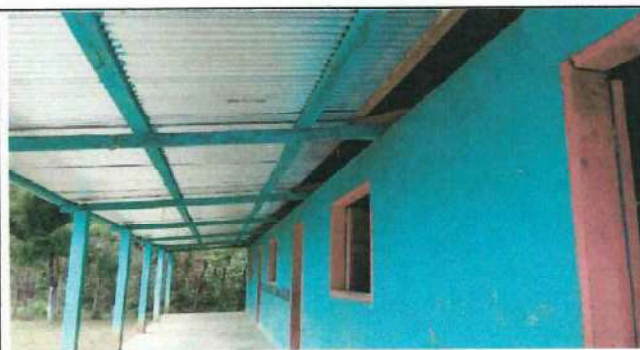
Foto 4: Corredor de las tres aulas, con la necesidad de cambiar las reglas o costaneras.
